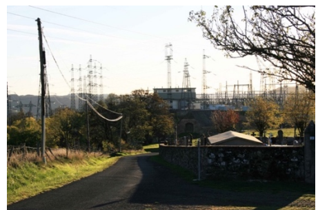
Poste de RUEYRES.
